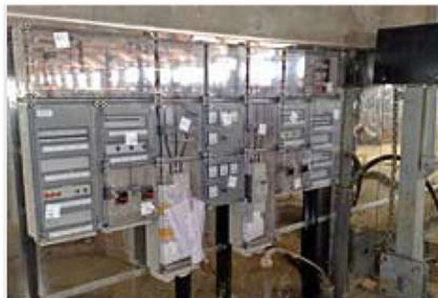
Модульный распределительный щит. Животноводство
