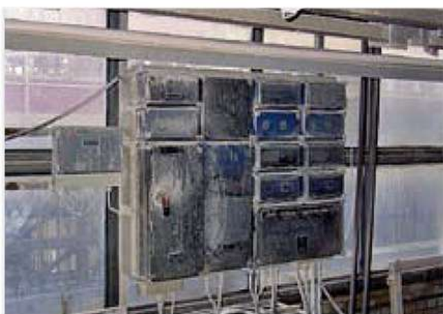
Модульный распределительный щит. Цинкодобывающая шахта
