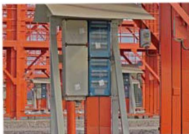
Модульный распределительный щит. Портовый комплекс
